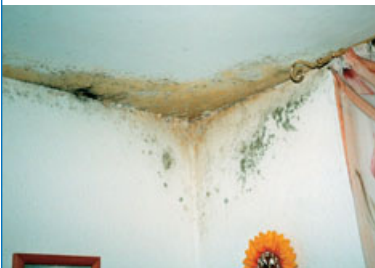
Bild 4: Schimmelpilzbefall undichtes Flachdach
